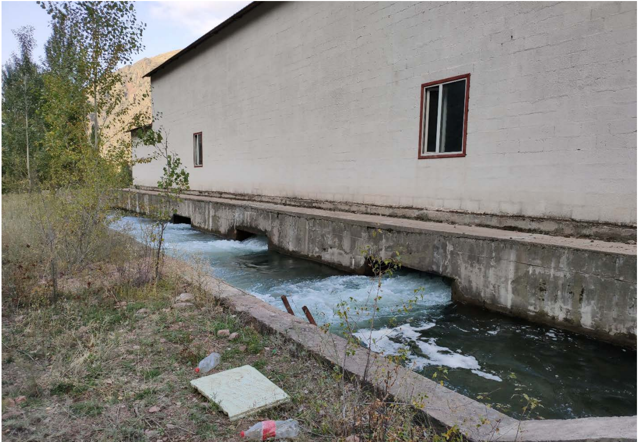
Рис 6. Место выхода потока воды от генераторов
