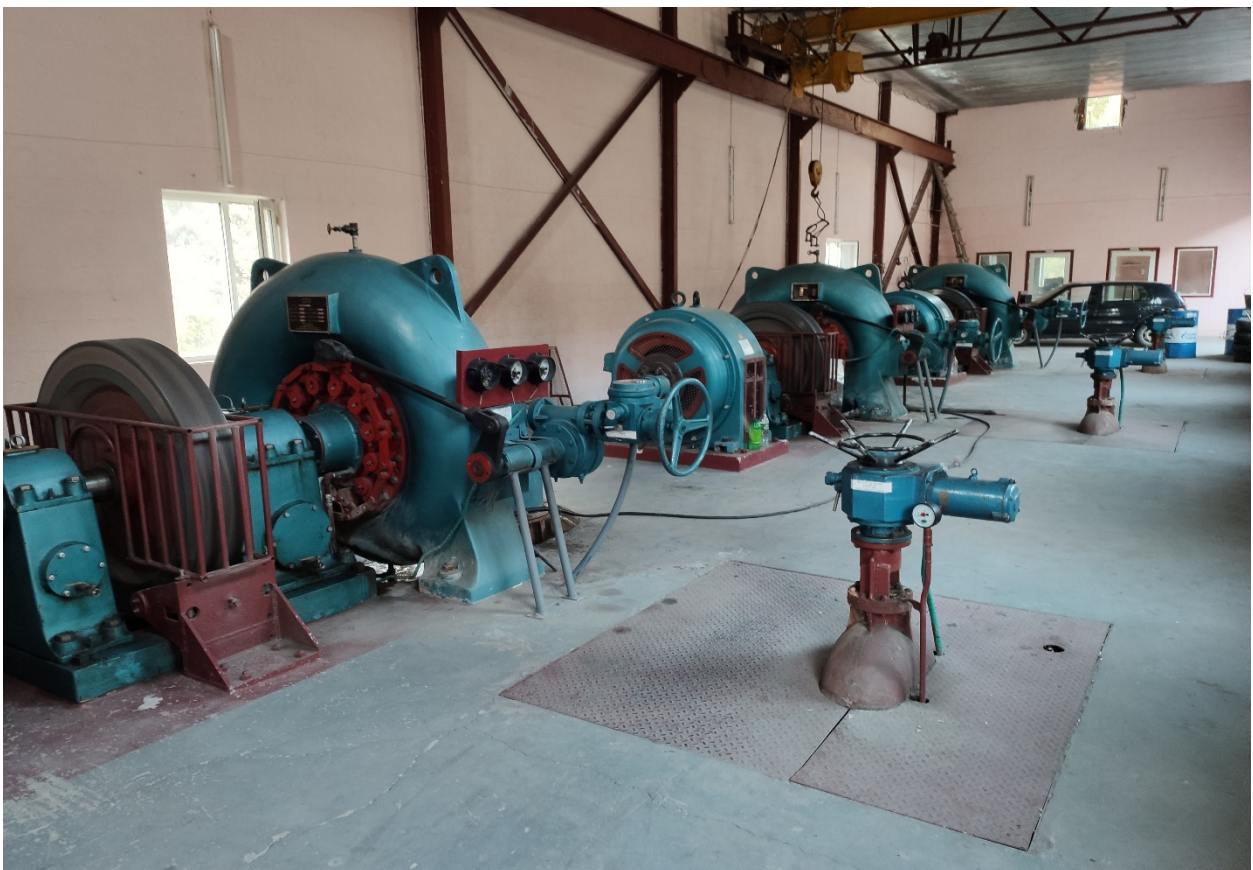
Рис 3. Электрогенераторы малой ГЭС
