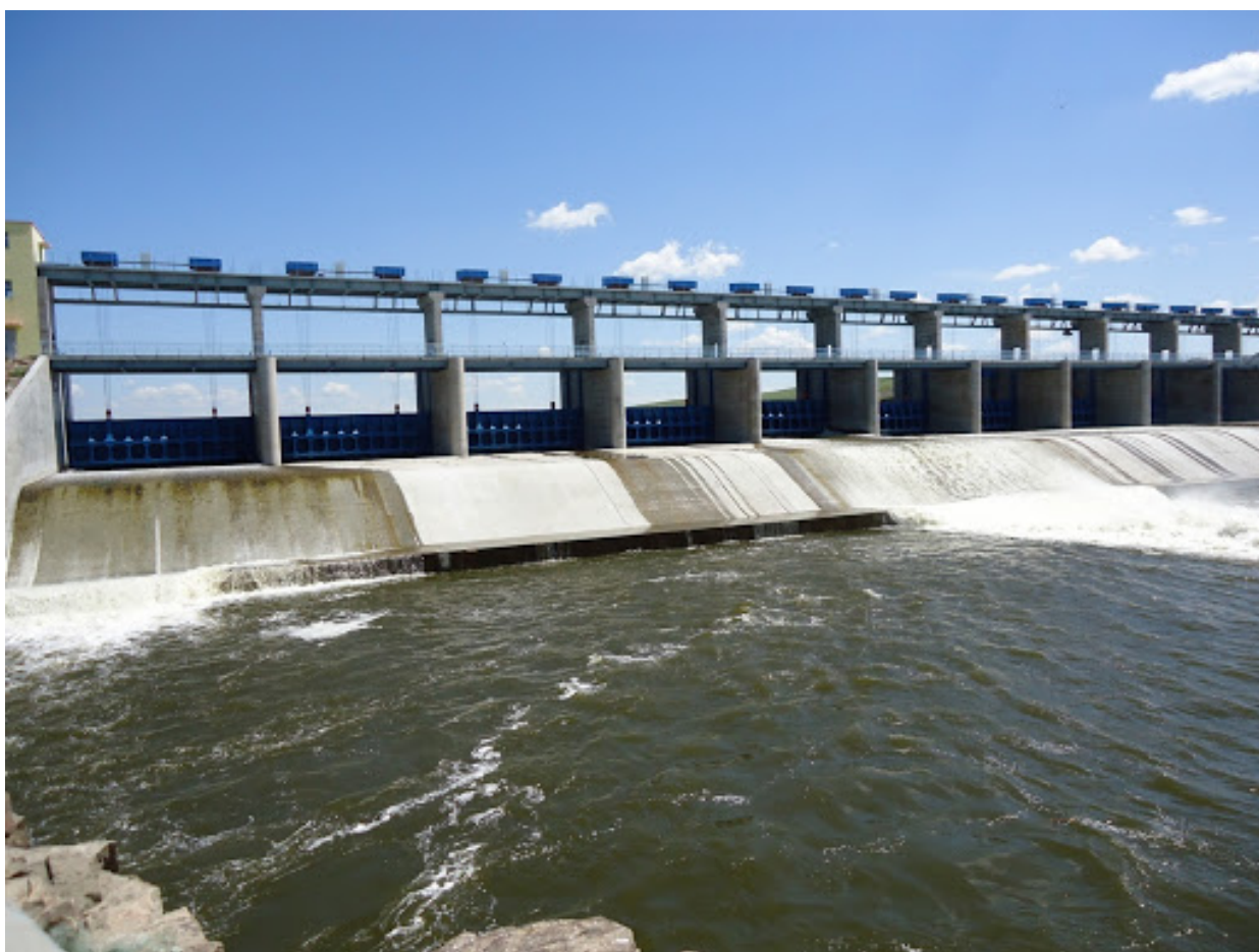
Рисунок 2. Дамба Интумакского водохранилище
