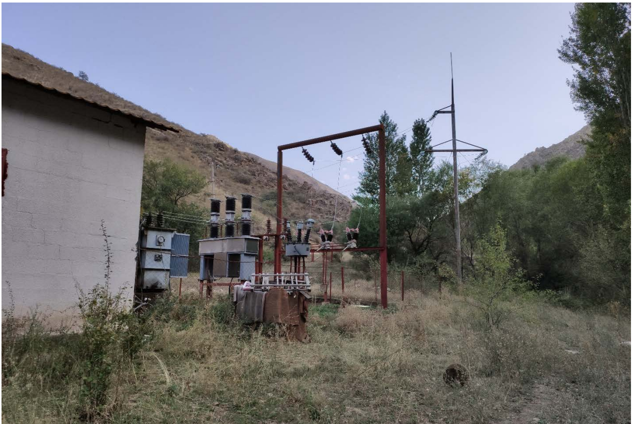
Рис 5. Место подачи электроэнергии в общую электросеть
